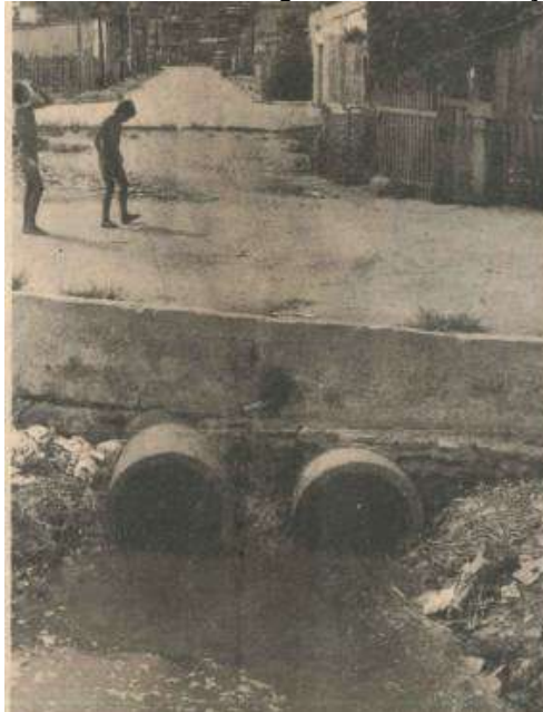
Figura 107 - São Pedro I, 1985: Esgoto doméstico lançado ao ar livre.
